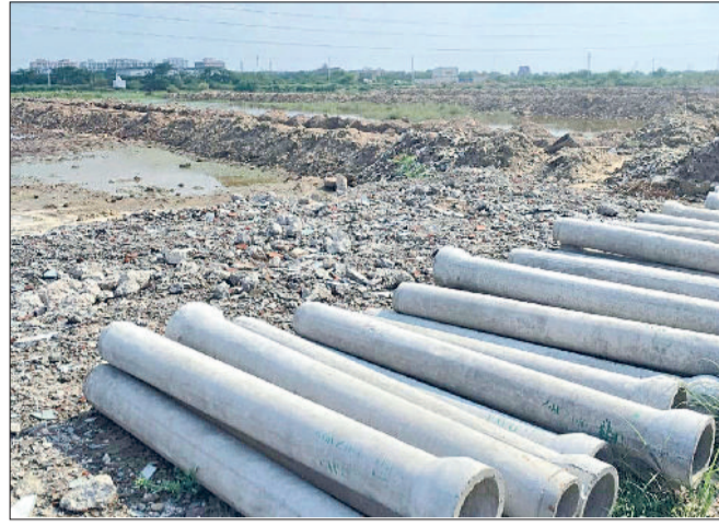
बहादुरगढ़। अवैध रूप से काटी जा रही कॉलोनी में रखे सीवर लाइन के पाइप।
